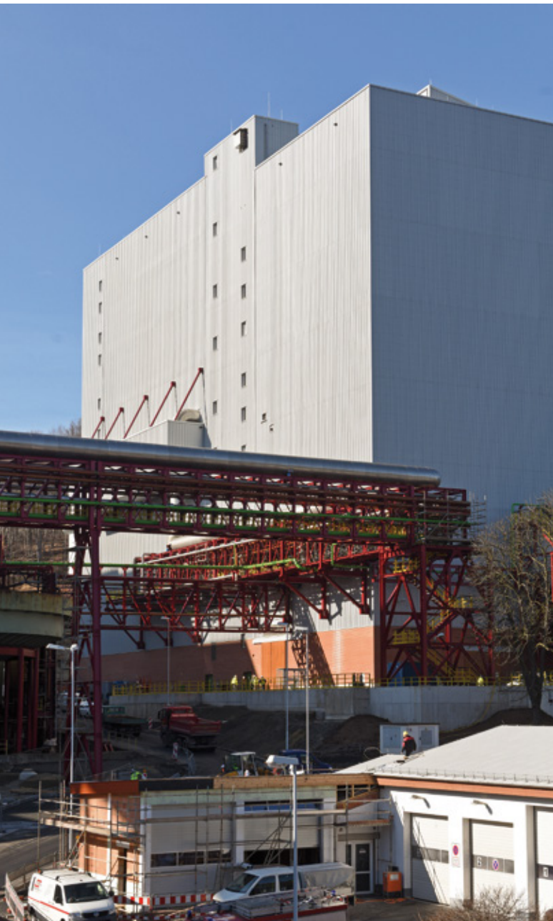
Abbildung 3: Die neu errichtete KKF-Anlage am Standort Hattorf (Philippsthal) des Werkes Werra der K+S KALI GmbH
