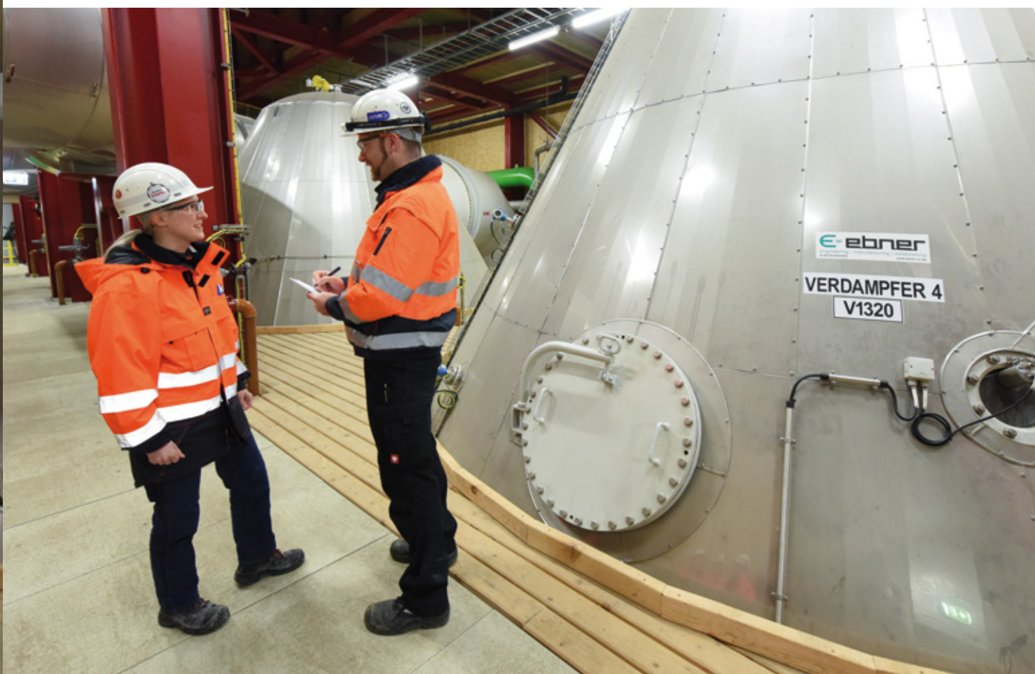
Abbildung 9: Die in der neuen KKF-Anlage eingebauten Verdampfer
