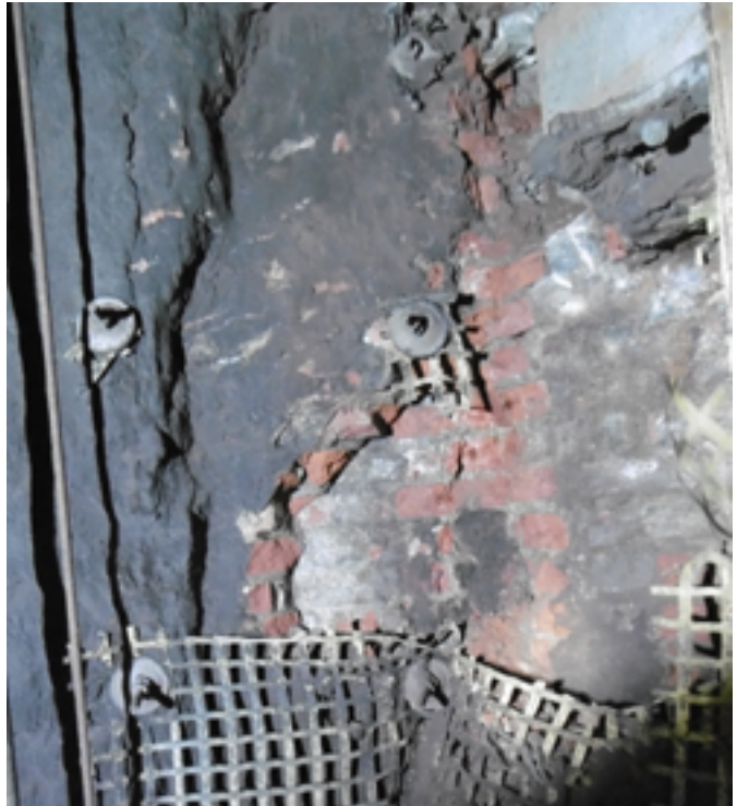
Abbildung 4: Typischer Mauerwerksschaden im Schachtausbau, Schaden und Ausbruch über mehrere Klinkerlagen
