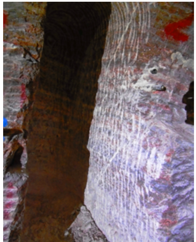
Abbildung 6: Aufgefräster Versuchspfeiler, rechts sichtbarer Injektionsanker und zusätzliches Injektionsrohr (oberhalb) sowie die injizierten Klüfte (diagonal, hell, Bildmitte)
