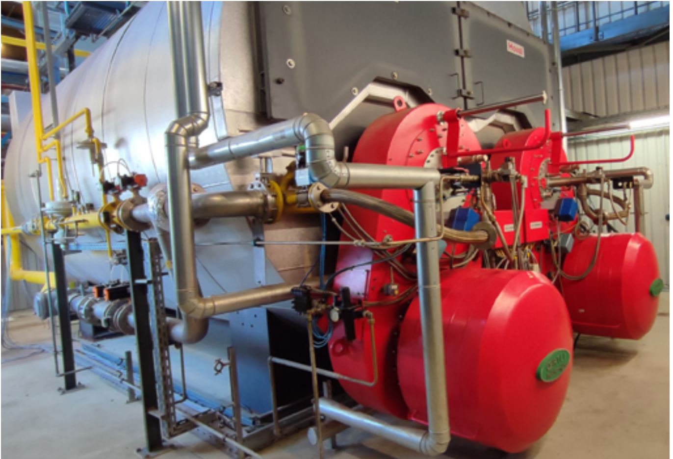
Dampferzeuger mit Doppelbrenneranlage
