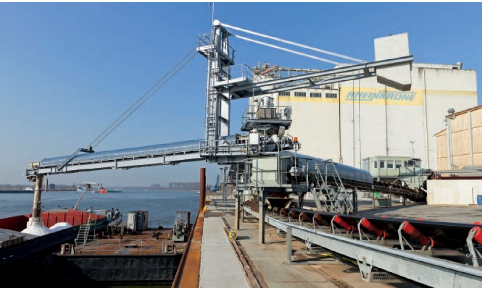
Produktschonender und staubarmer Schüttgutumschlag: Losebelader mit abgedeckten Förderwegen bei der Beladung eines Binnenschiffes.
