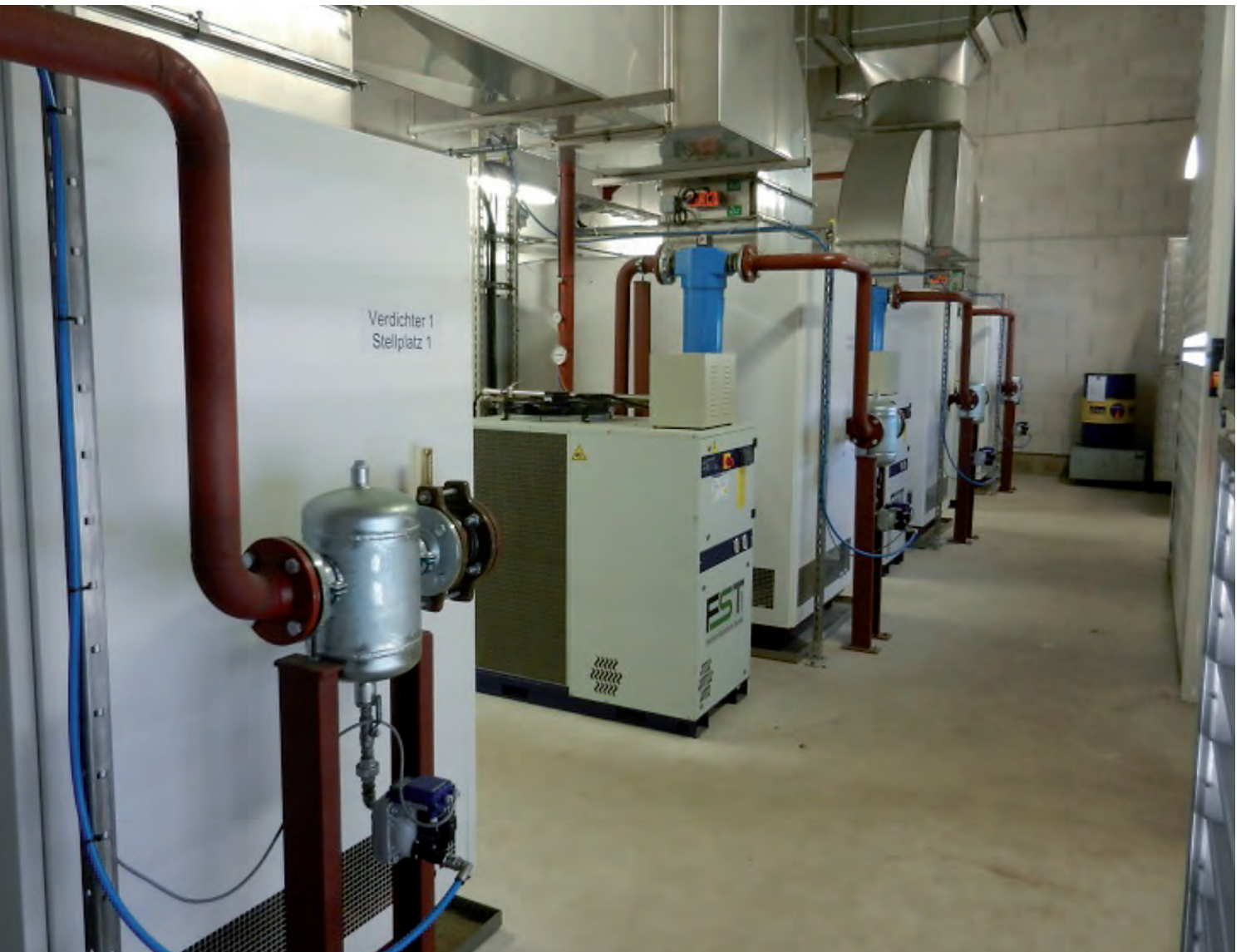
Abbildung 11: Anlagen zur Druckluftherzeugung
