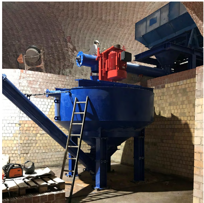
Abbildung 6: Im Aufbau befindlicher Löseapparat mit Peripherie
