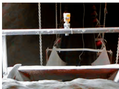
Abb. 6: Ultraschallsonde im eingebauten Zustand
