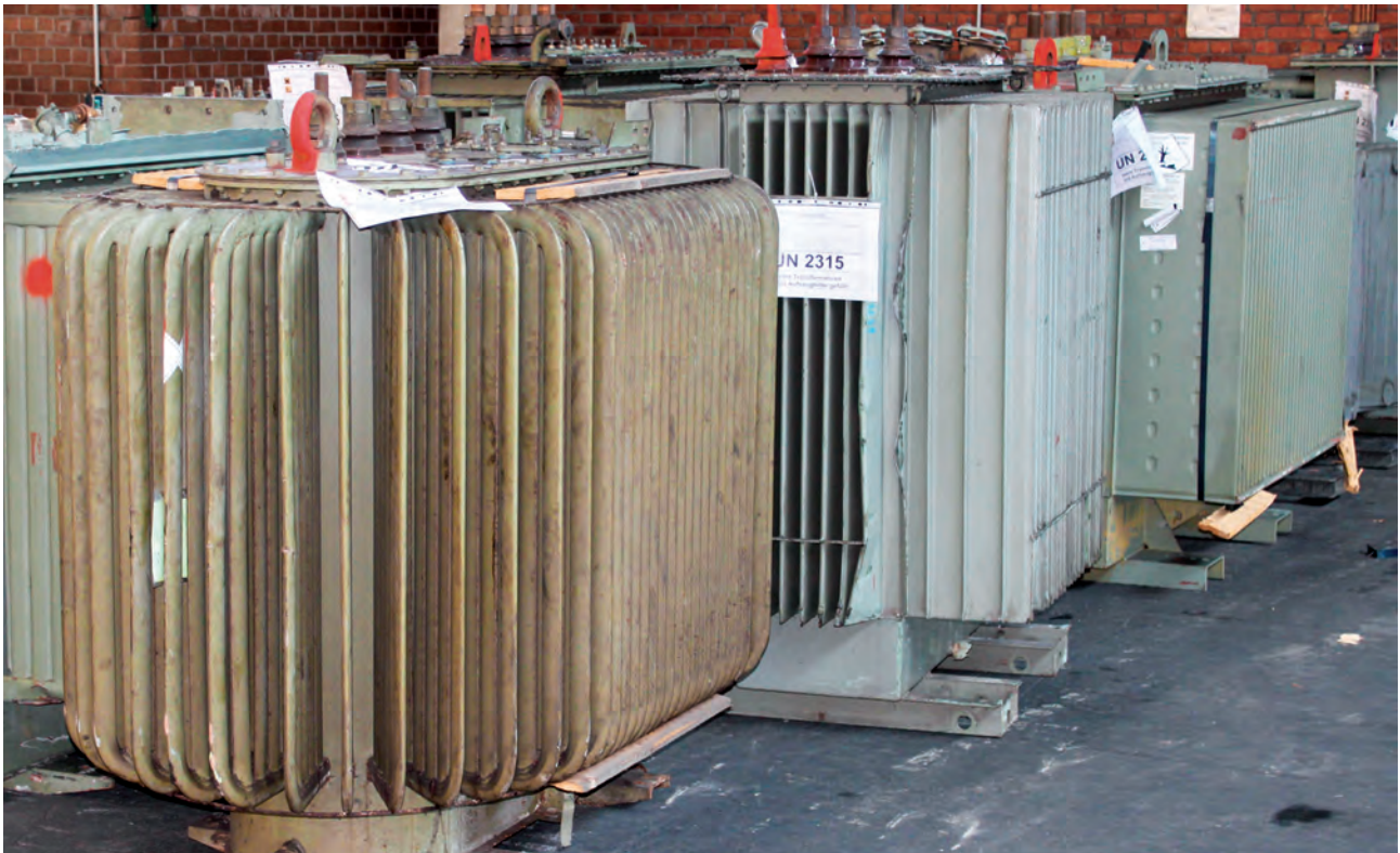
Abb. 6: Ausgelagerte Transformatoren über Tage auf dem UTD-Gelände, Foto: K+S
