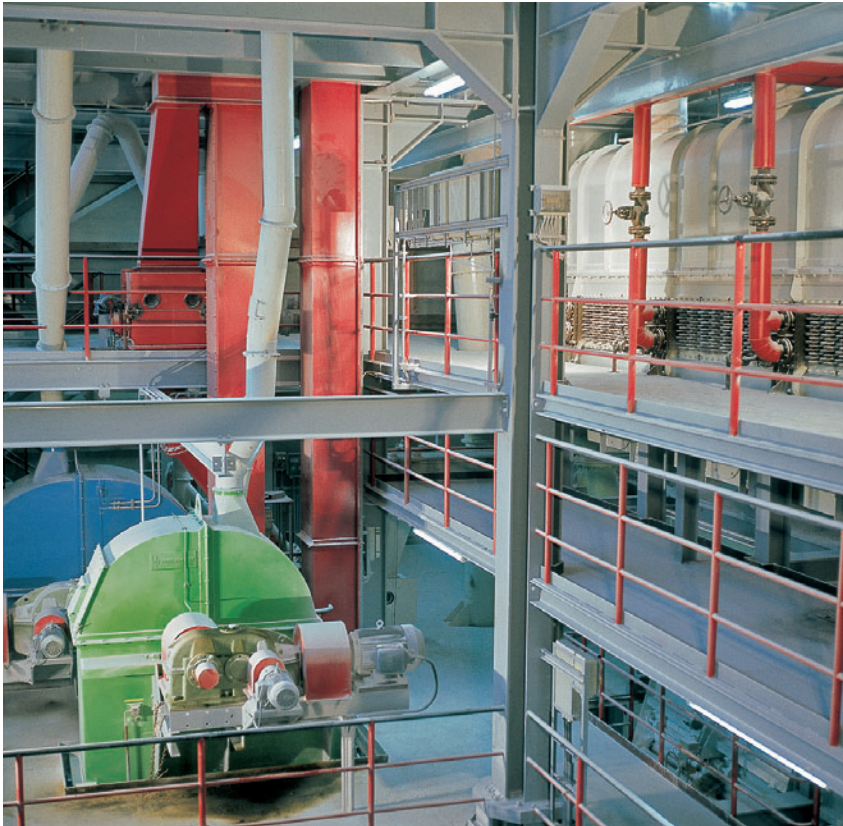
Abb. 9: Die ESTA-Anlage des Kaliwerkes Wintershall erstreckt sich über mehrere Stockwerke – Aufnahme aus dem Jahr 1979
