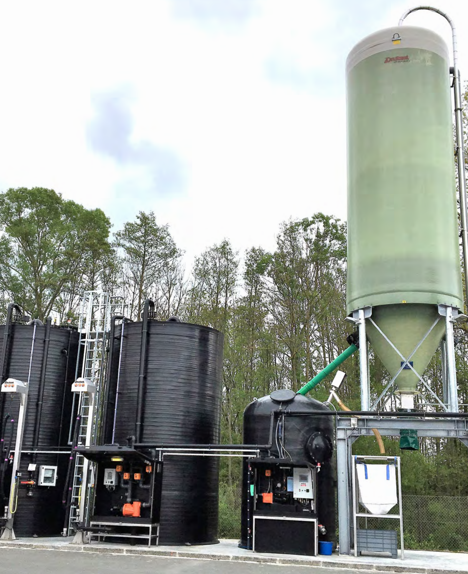
Abbildung 1: Salzlöseanlage und Solelagerung in der Autobahnmeisterei Hirschaid
