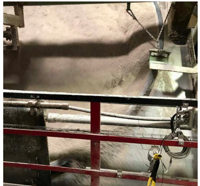
Abbildung 2: Granulierteller am Standort Neuhof-Ellers mit Abwurfschurre.
