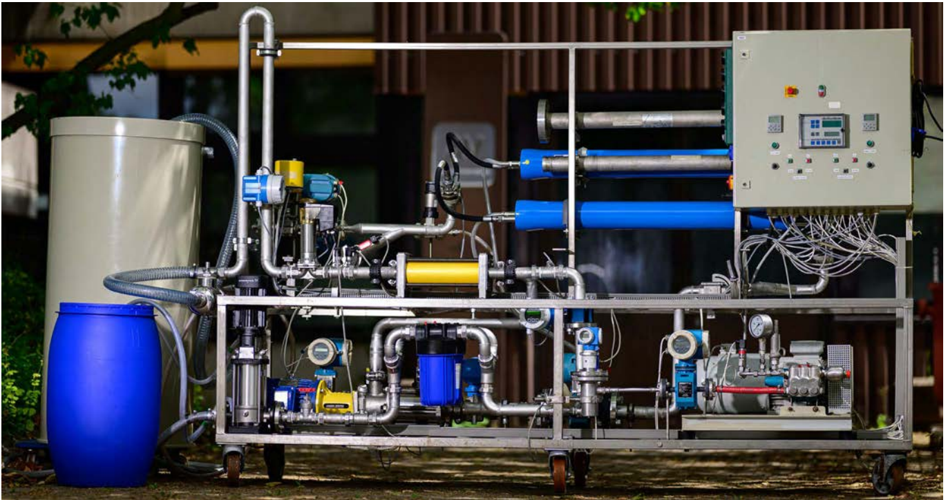
Abbildung 5: Pilotanlage zur Hochdruck-Nanofiltration
