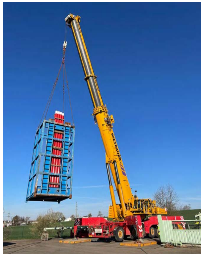
Abbildung 6: Die Leerrohre werden in einem Gestell mittels Mobilkran in den Schacht gehoben [Foto: SWS]
