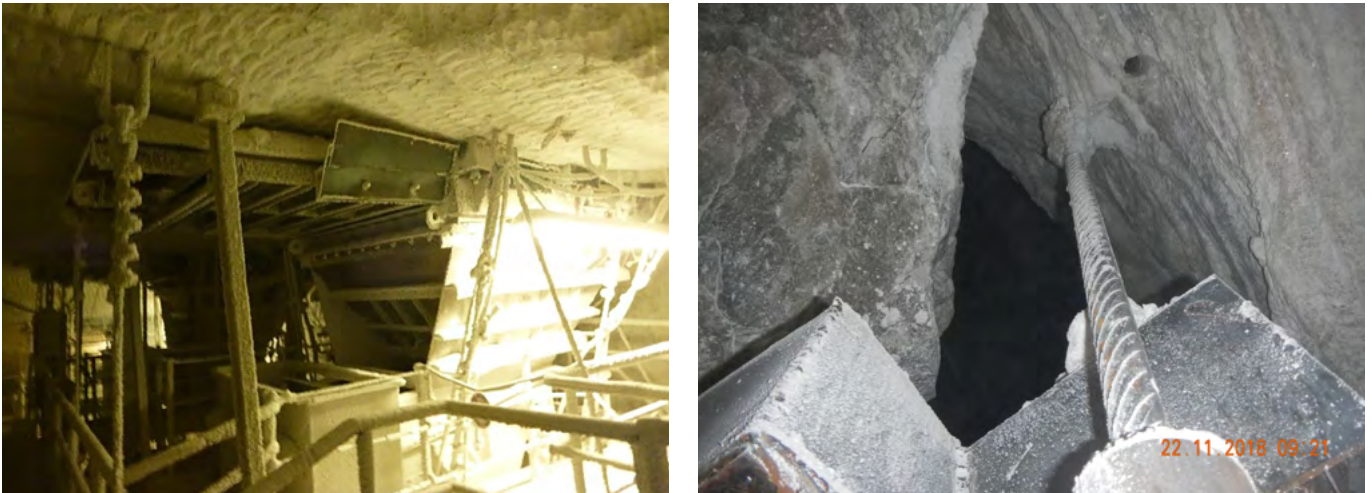
Abbildung 3: Auswaschungen/Ausbrüche im Bereich der Austragsvorrichtungen
