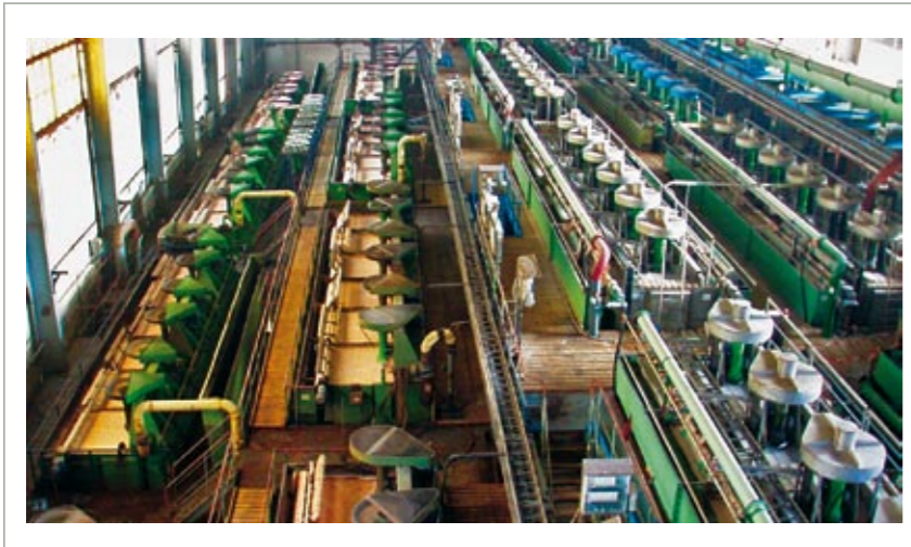
Abb. 2: Bewährter Betrieb von Rührwerkskaskaden zur Flotation im Werk Zielitz / Proven operation of agitator cascades for flotation at the plant Zielitz
