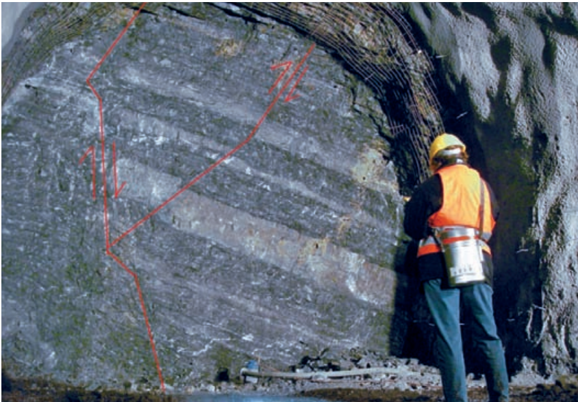
Abb. 4: Mehrfach gestörte Ortsbrust innerhalb der Unteren Hauptmuschelkalk-Formation / Multiple faults in a heading face within the Untere Hauptmuschelkalk-Formation
