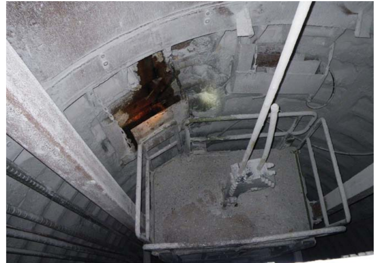
Abb. 4: Austritt von Wasser und Dowell-Seal an der Unterkante der Vorbausäule / Leakage of water and Dowell-Seal at the lower edge of the steel shaft lining
