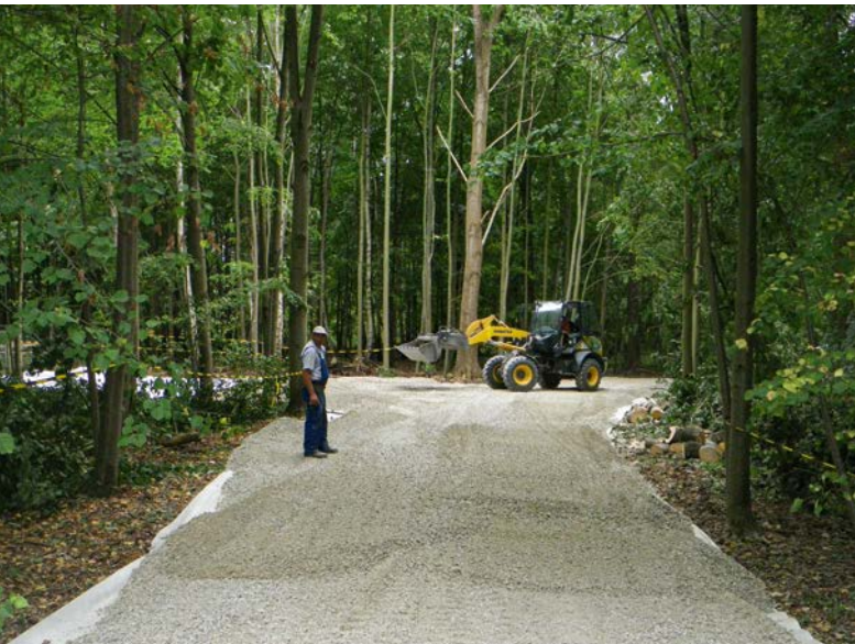
Verfüllung des Schachtes Oedesse des früheren Bergwerkes Berkhöpen-Oedesse (in der Nähe von Peine) (begonnen 2013). Der 1905 abgeteufte, 905 Meter tiefe Schacht Oedesse war von 1913 bis 1925 in Betrieb. 1936 kam es zu einem Wassereinbruch; in der Folge ist das Bergwerk vollkommen abgesoffen. Die Übertageanlagen wurden ab 1937 abgerissen und der Bauschutt in die Schächte verfüllt. Der Schacht Oedesse war mit einem Betondeckel verschlossen. Im Bild: Herrichtung einer Zufahrtstraße zum Schachtdeckel.
