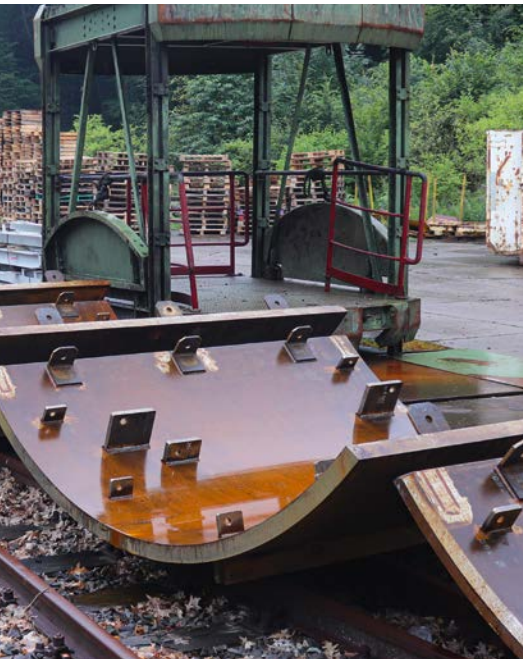
Die in Reih und Glied abgelegten Stahlblechsegmente, die im Schacht miteinander zur Vorbausäule verschweißt wurden.
