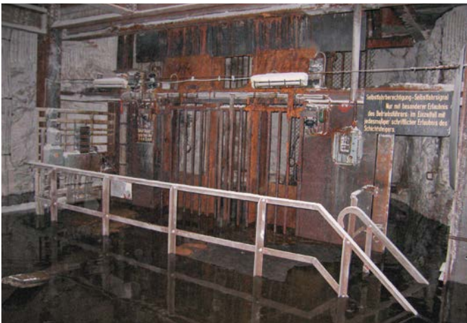
Flutung des Grubengebäudes des Werkes Bergmannsseggen-Hugo: ein überfluteter Füllort
